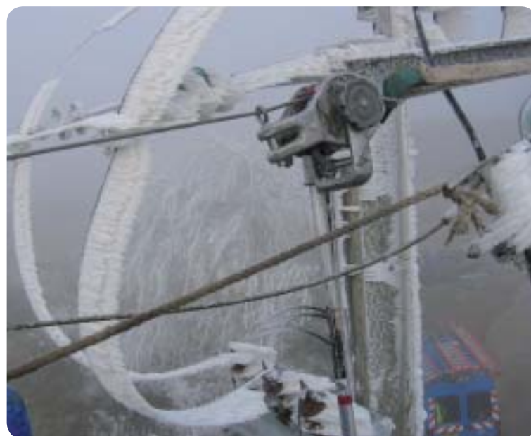
Manchons de glace sur les réseaux aériens
