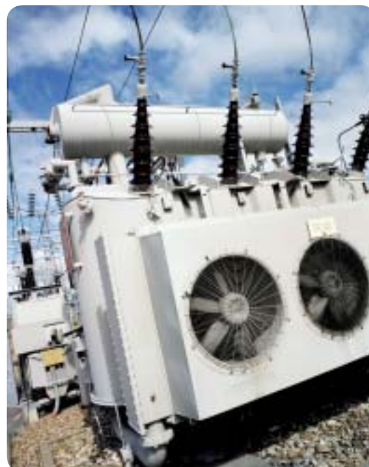
Transformateur HTB/HTA dans un poste source
